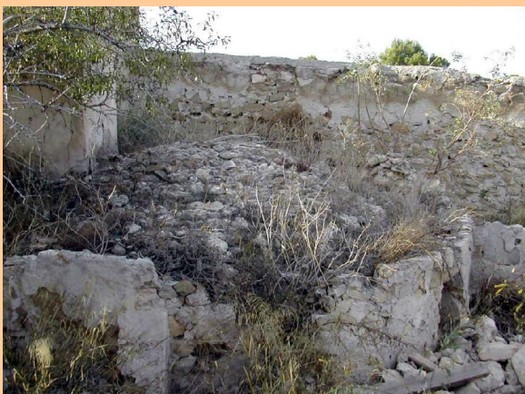
Bóveda semiesférica de piedra por aproximación de hiladas en el aljibe de Lo Zafra.
