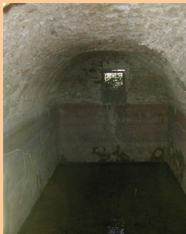
Interior del aljibe de bóveda de Lo Meca. Sus dimensiones aproximadas (3x3x7) dan una capacidad de 60-70 m 3 , acorde con la importancia de una finca extensa con bodega, almazara y una buena cantidad de animales que abrevar. Llama la atención el tamaño de las aberturas de aporte de agua y derramador que se cierran con ventanas enrejadas de unos 60x70 cm.
